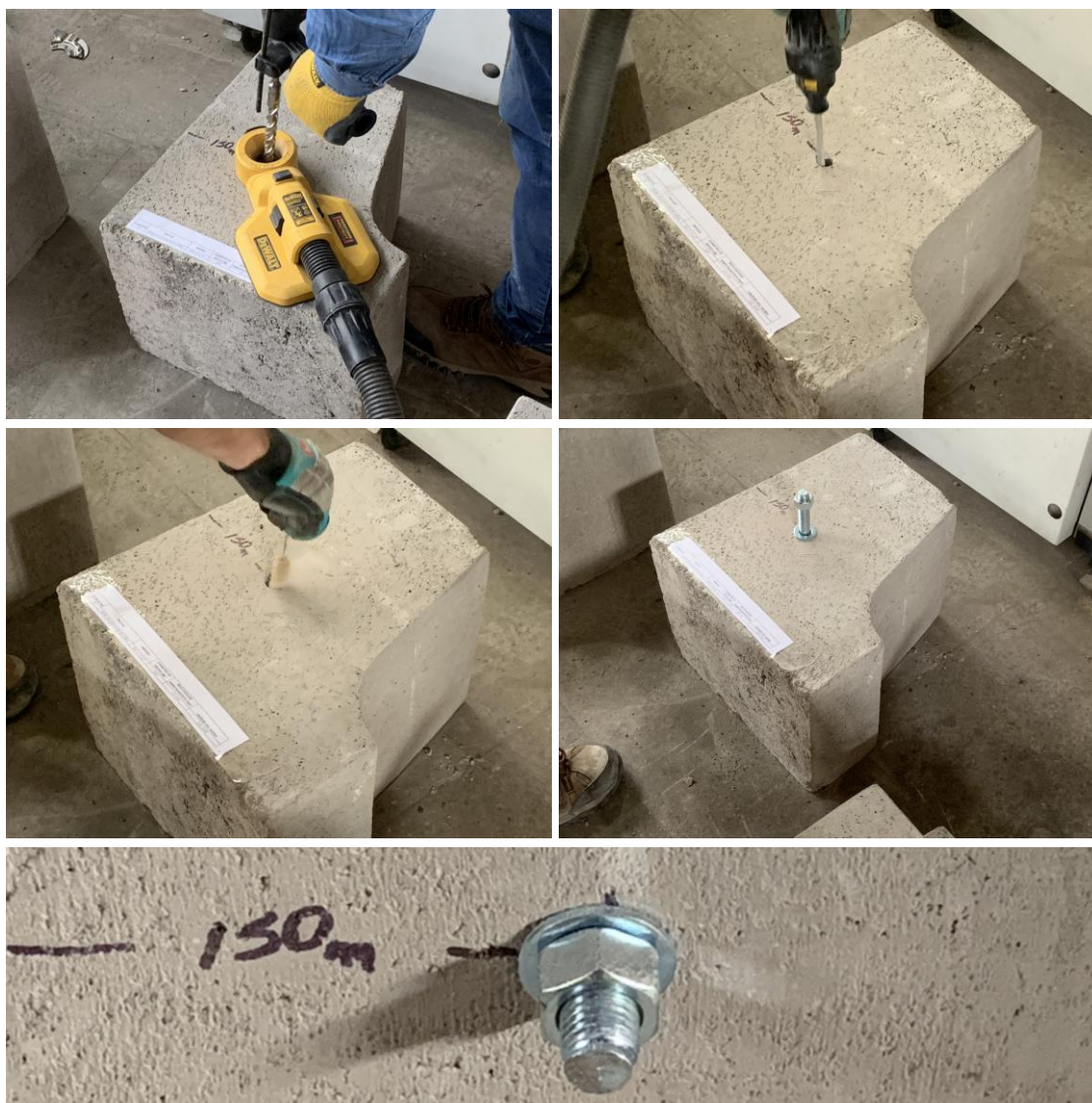
Figura B.1 Imagen del proceso de limpieza e instalación de las muestras recibidas.
